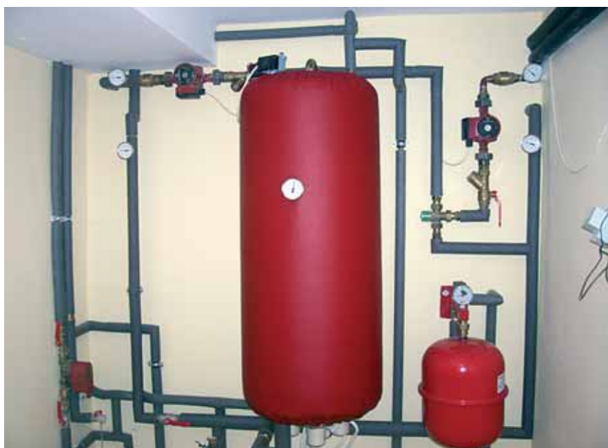
Rys. 1. Wielofunkcyjny wymiennik ciepła wykonuje kilka istotnych zadań w układzie c.o.
